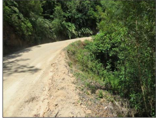
Deslizamento a ser protegido
