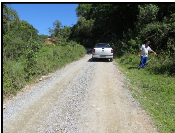
Bueiro transversal esconso a ser substituído
