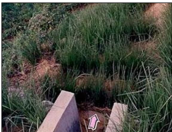
Saída de bueiro protegida com vetiver
