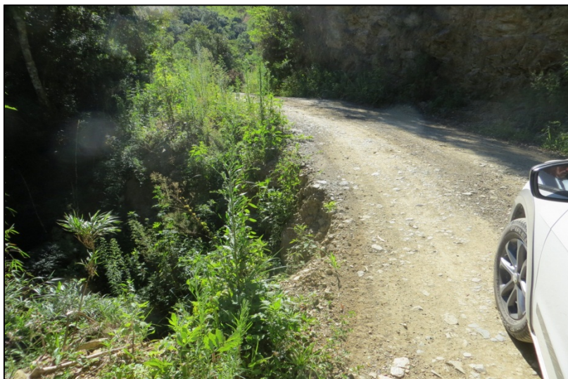
Deslizamento a ser sinalizado com Euterpe e Caeté
