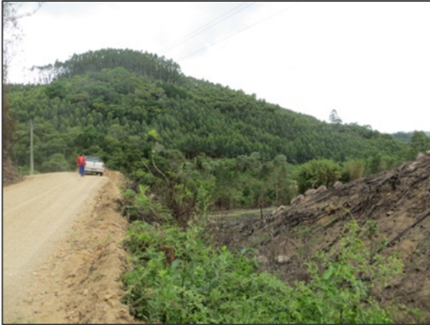
Deslizamento a ser protegido
